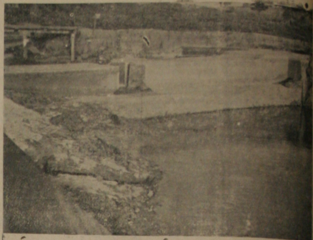
Outro aspecto da barragem do rio Pitanga em "Cabrita", não funciona há cerca de três anos. O rio corre sem nenhum impedimento pela cabeceira direita da antiga barragem, impedindo o aproveitamento das suas águas.
