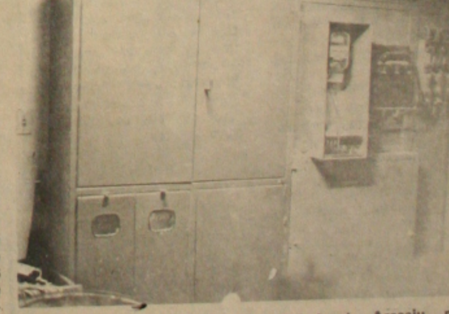
Detalhe da casa de força do Edifício Cidade de Aracaju, no subsolo.
