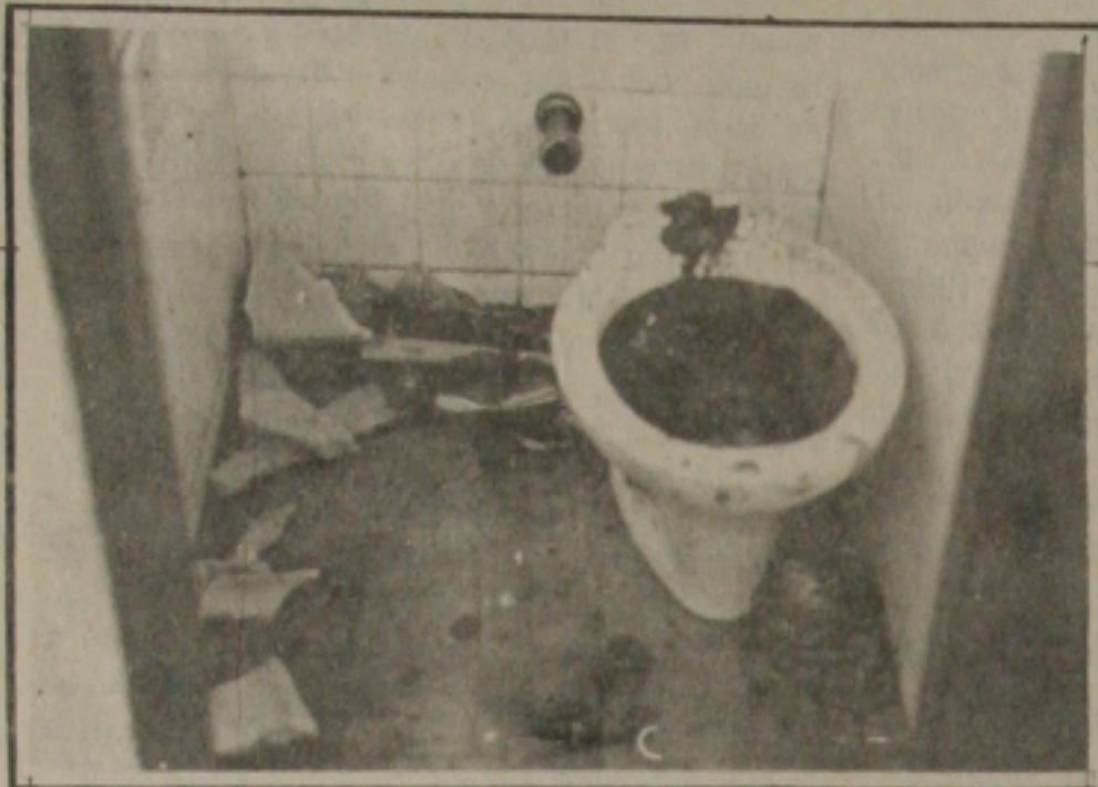
Este vaso sanitário está praticamente cheio de fezes, mesmo estando quebrado. A falta de higi-
