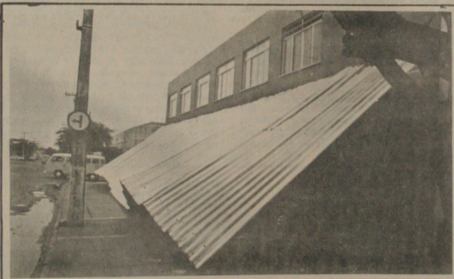
Aqui, uma cobertura desabou em cima de um carro. (Foto de Luiz Moreira)
