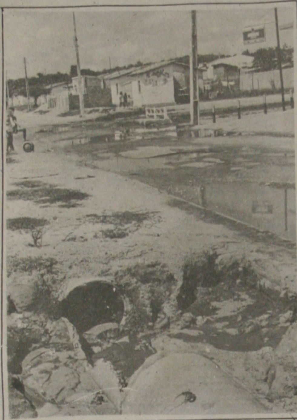
As ruas estão esburacadas e a rede de esgotos danificada.
