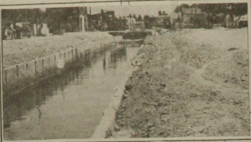
A recuperação dos canais de Aracaju foi retomada pela Prefeitura, que suspendeu as obras desde o início da administração do prefeito Wellington Paixão.
