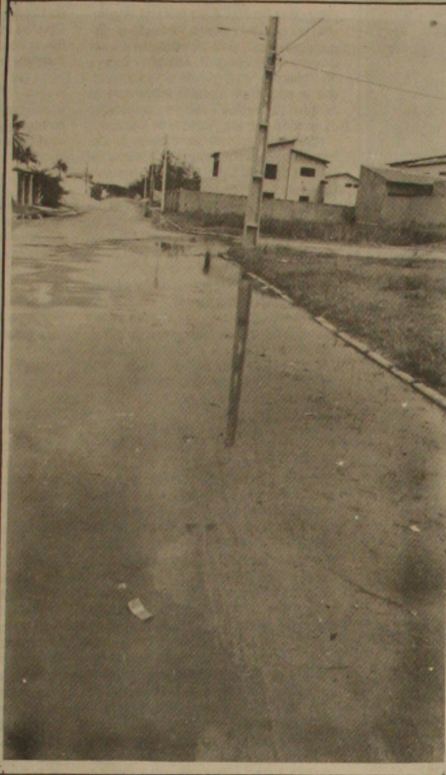
Com os esgotos obstruídos, diversas artérias de Aracaju ficaram alagadas pelas águas das chuvas.
