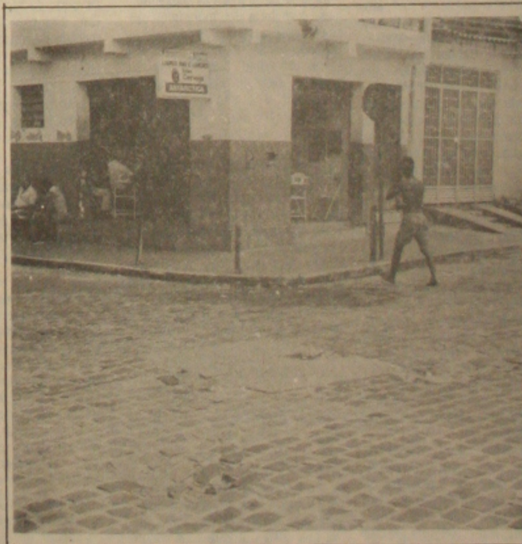
O esgoto transborda e causa péssimo odor em toda a área próxima ao Cirurgia.
