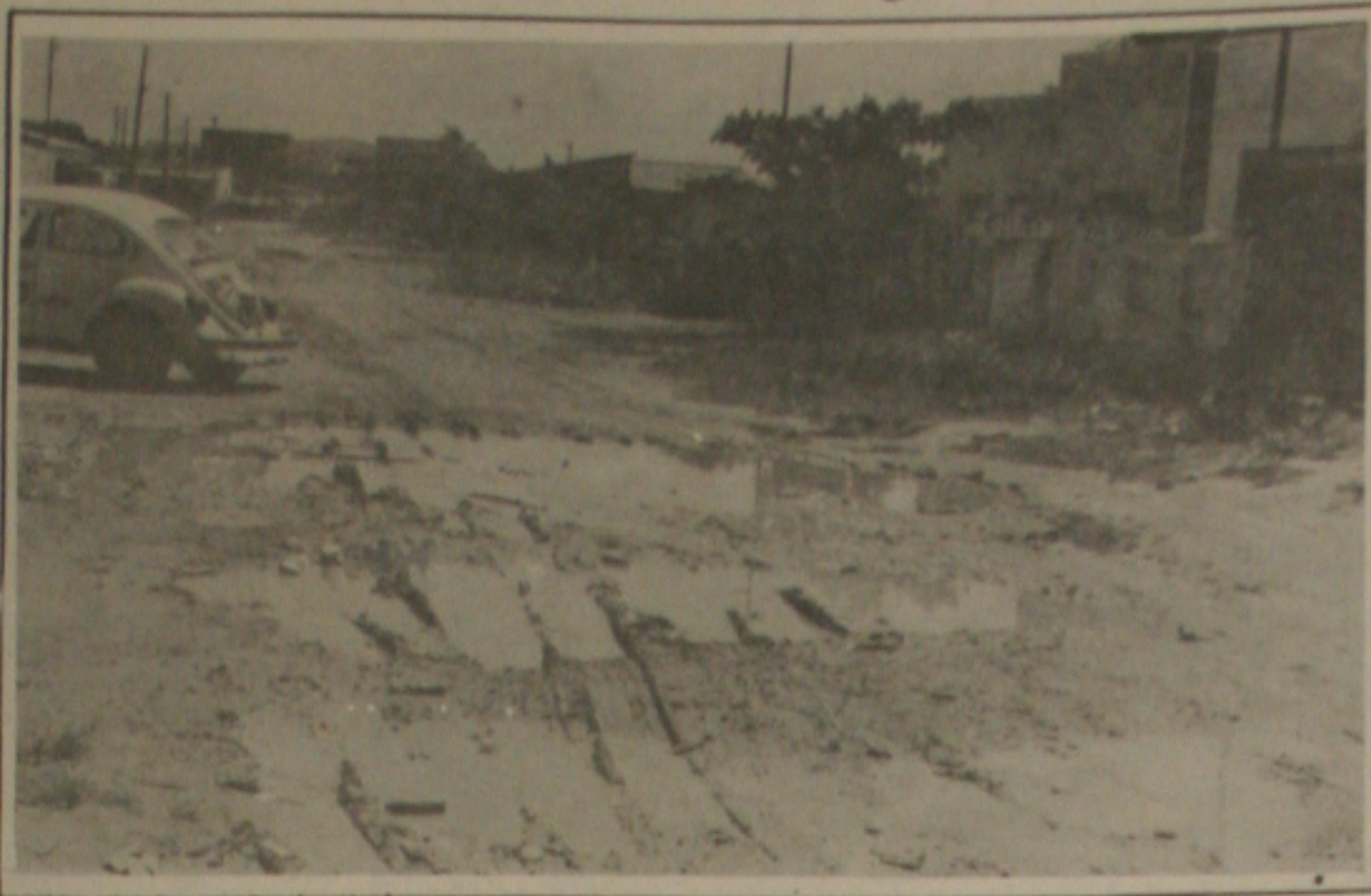
Na rua Oliveira Barros além do acúmulo de lixo tem-se muitos buracos.
