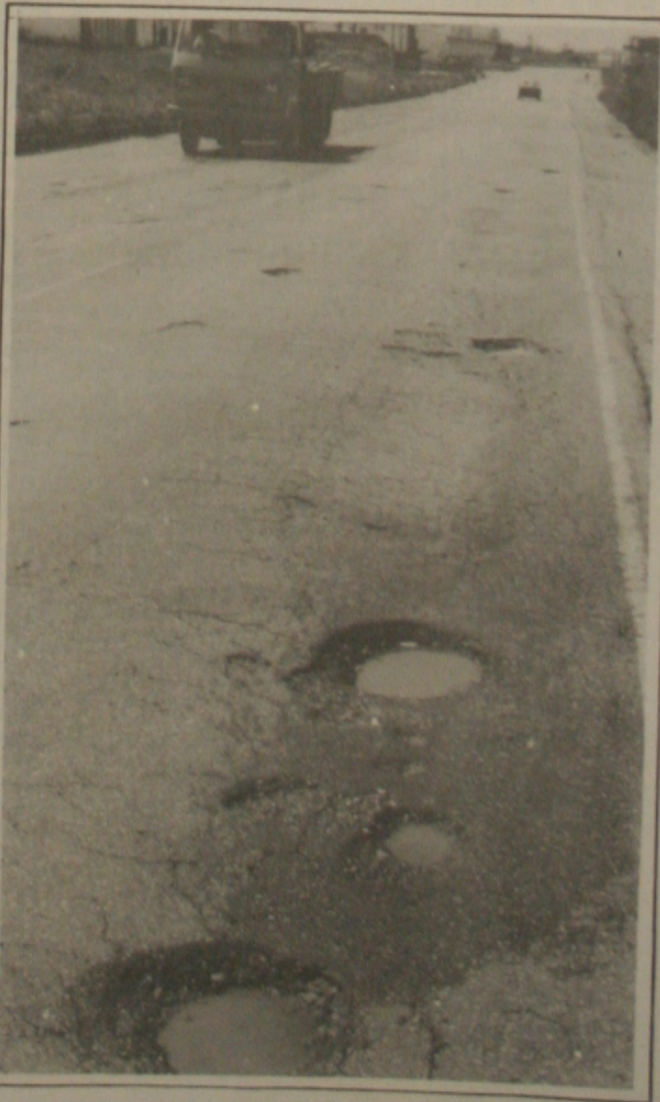
A BR-101 apresenta acostamento defeituoso capaz de provocar um acidente de grande proporção.
