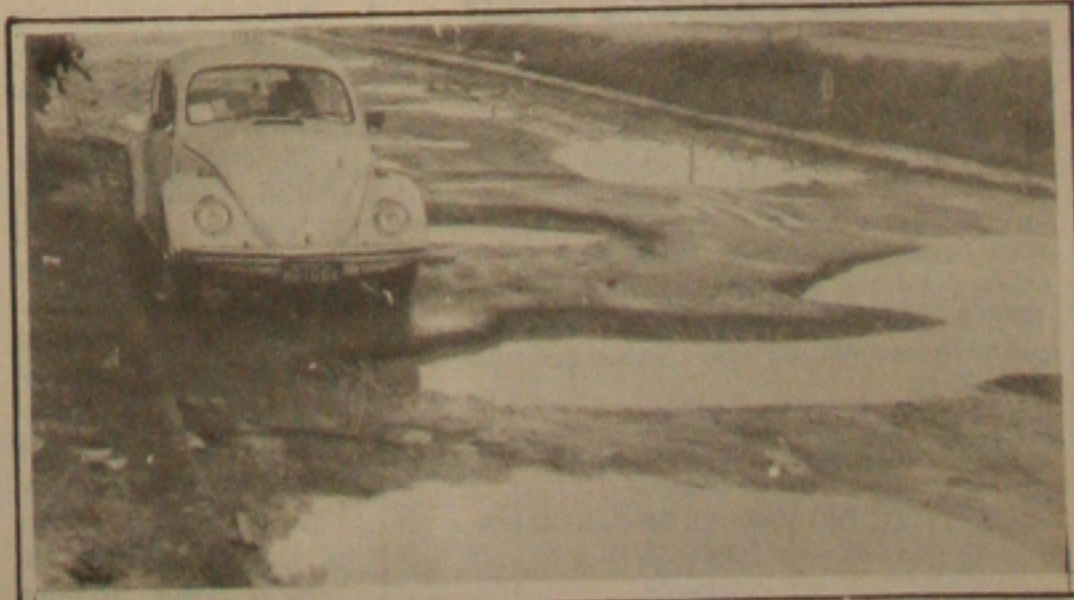
Ruas cheias de buracos no Bairro São Conrado.
