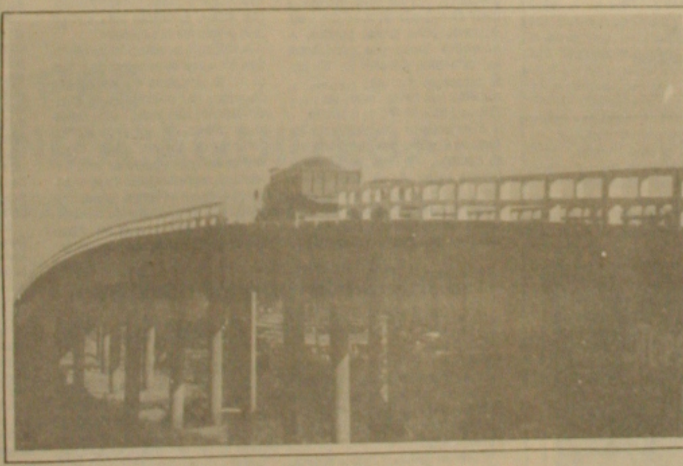
A ponte situada na avenida Tancredo Neves está precisando de proteção e reparos.
