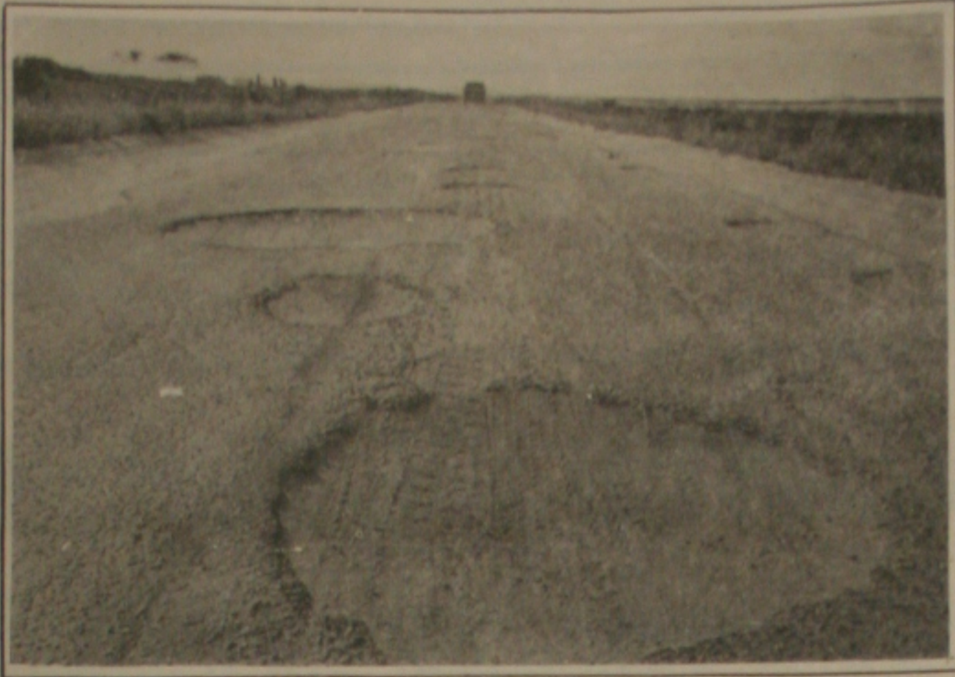
As rodovias vão demorar a ser recuperadas pelo DNER
