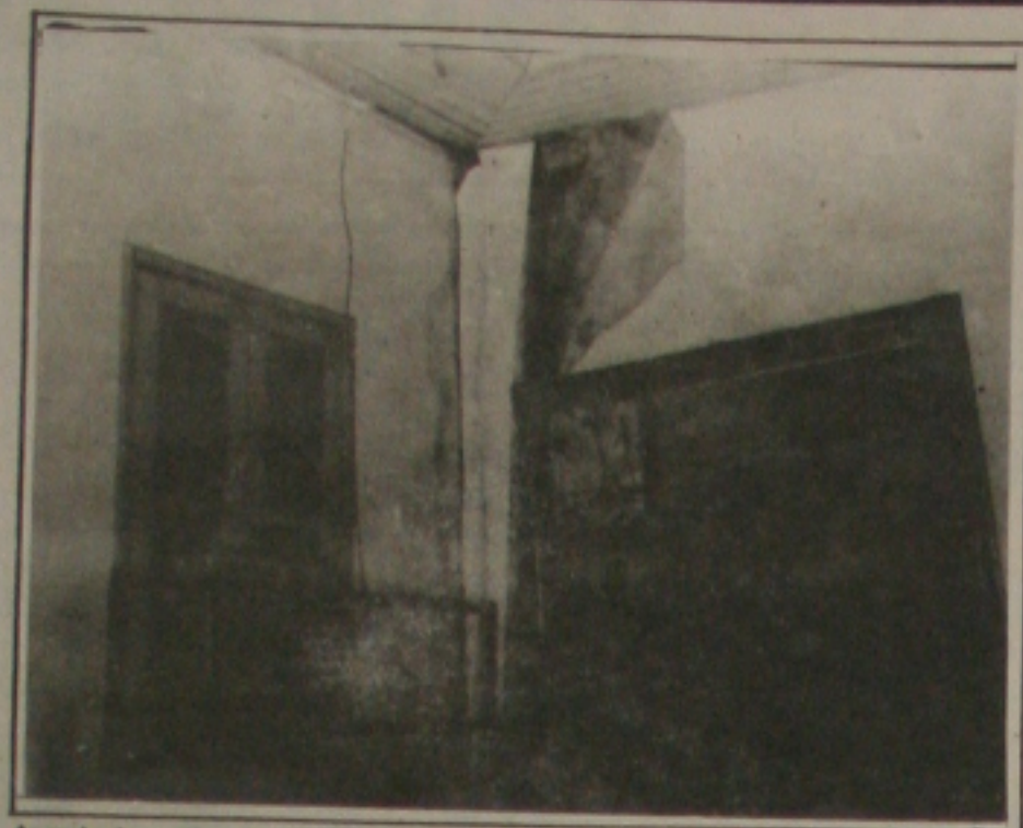
As rachaduras são enormes e o teto pode ruir.
