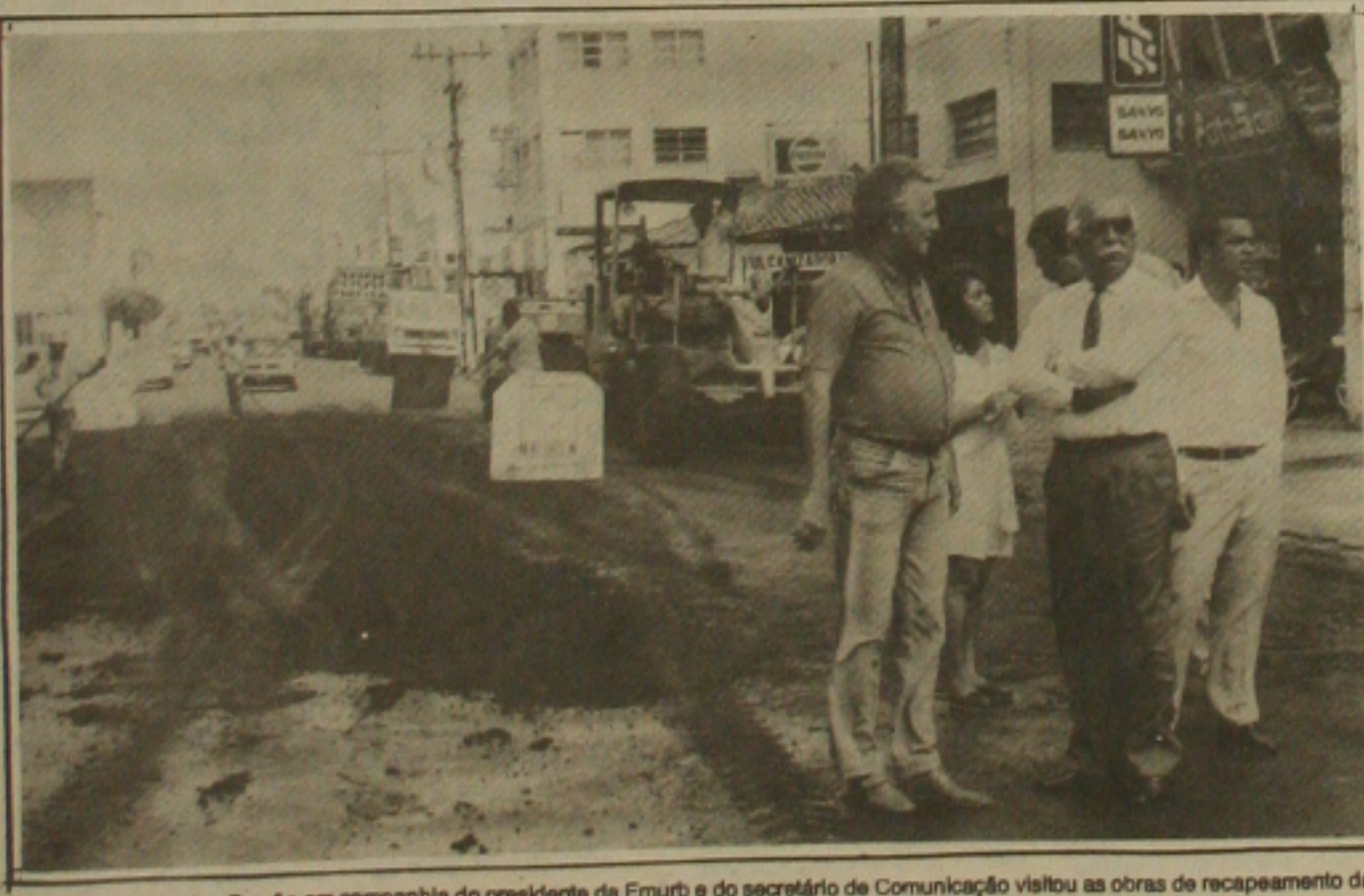
O prefeito Wellington Paixão em companhia do presidente da Emurb e do secretário de Comunicação visitou as obras de recapeamento da Rua Mariano Salmeron.
