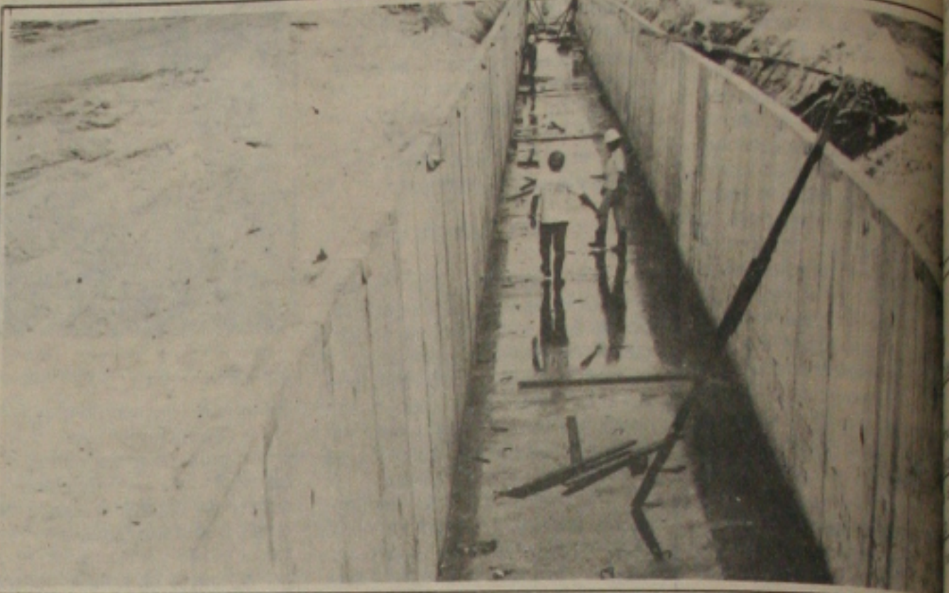
Outra obra importante de infra-estrutura na capital aracajuana: o canal da Avenida Sílvio Teixeira.
