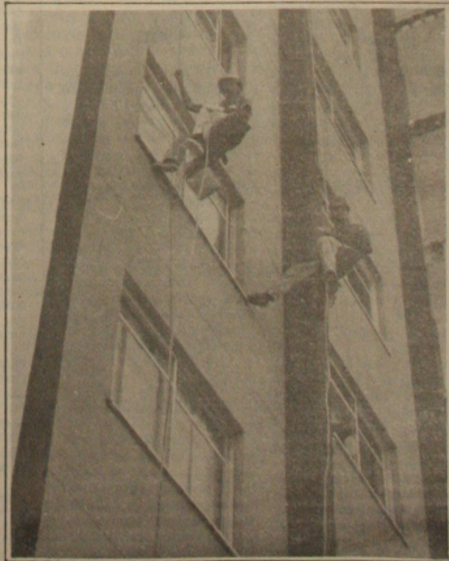
Construção civil: risco permanentes de acidentes.
