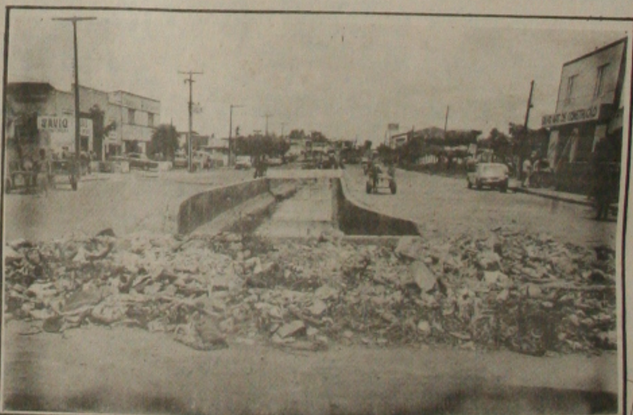
A maioria dos canais de escoamento da cidade estão completamente cheios de lixo.
