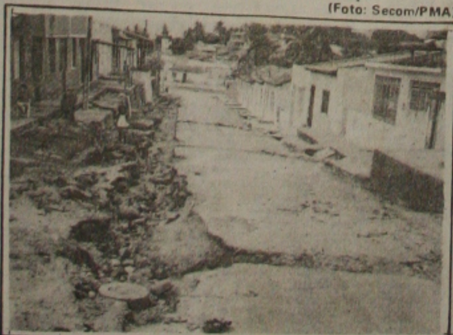
As obras do Deso destroem a malha viária de Aracaju
