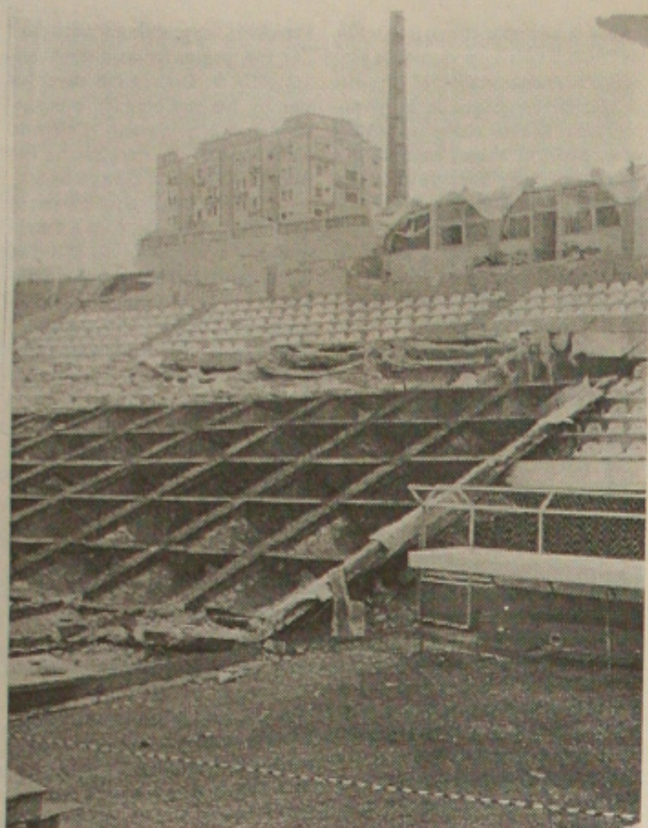
Fadiga pode ter causado o desabamento da cobertura
