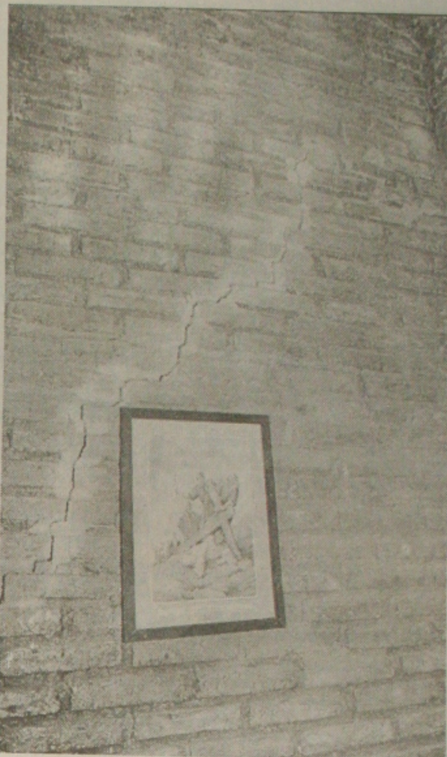
A Igreja Nossa Senhora do Carmo está com rachaduras
