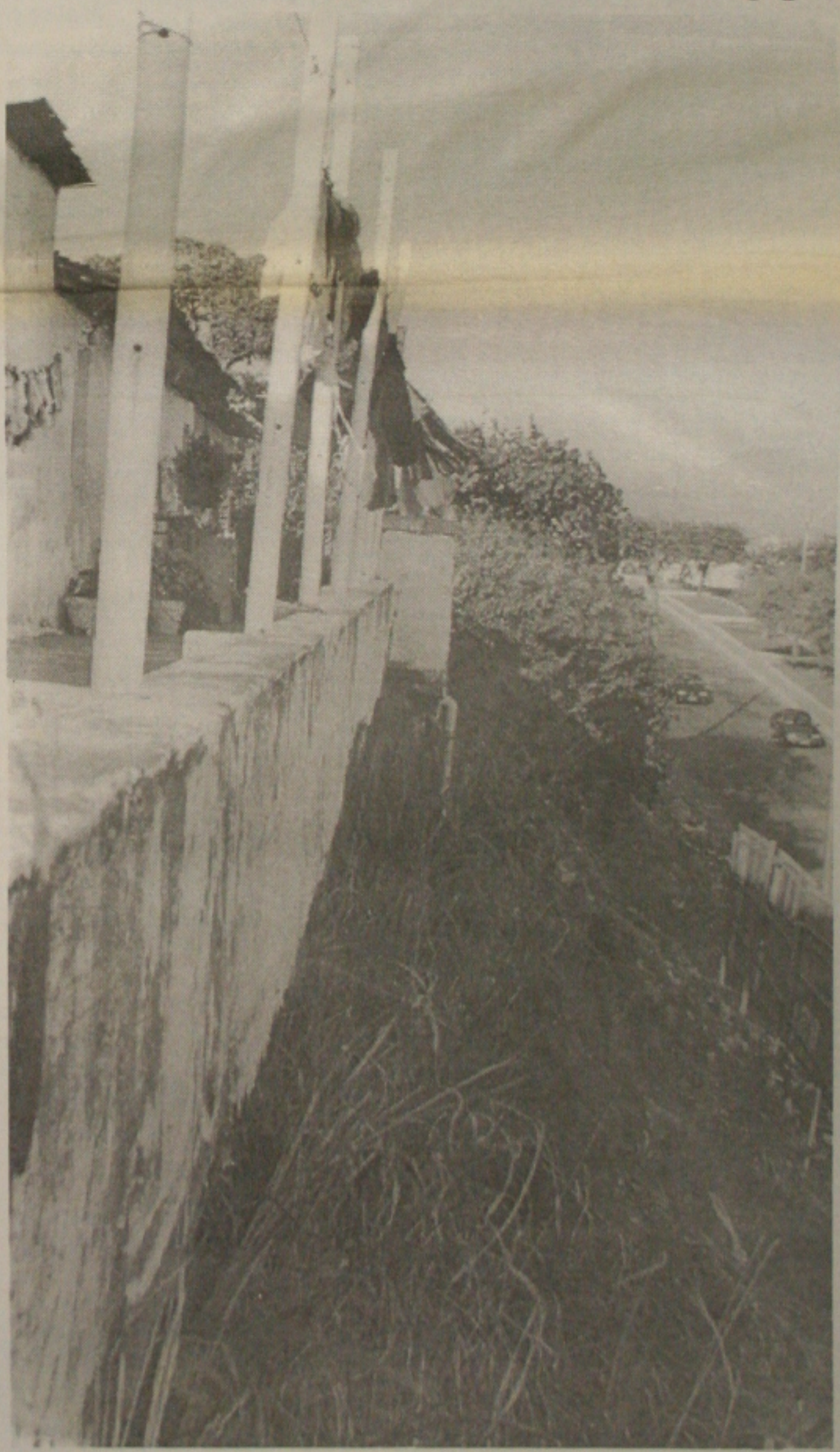
Na avenida Desembargador Maynard, muitas casas sobre encostas já foram condenadas pela Defesa Civil.
