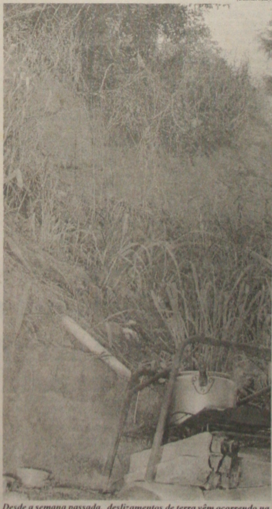
Desde a semana passada, deslizamentos de terra vêm ocorrendo na encosta que ameaçam soterrar a casa
