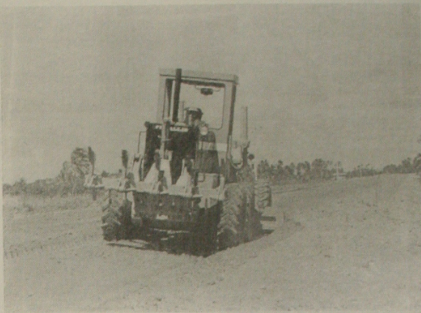
O Governo do Estado já investiu mais de R$ 70 milhões na construção e recuperação de rodovias
