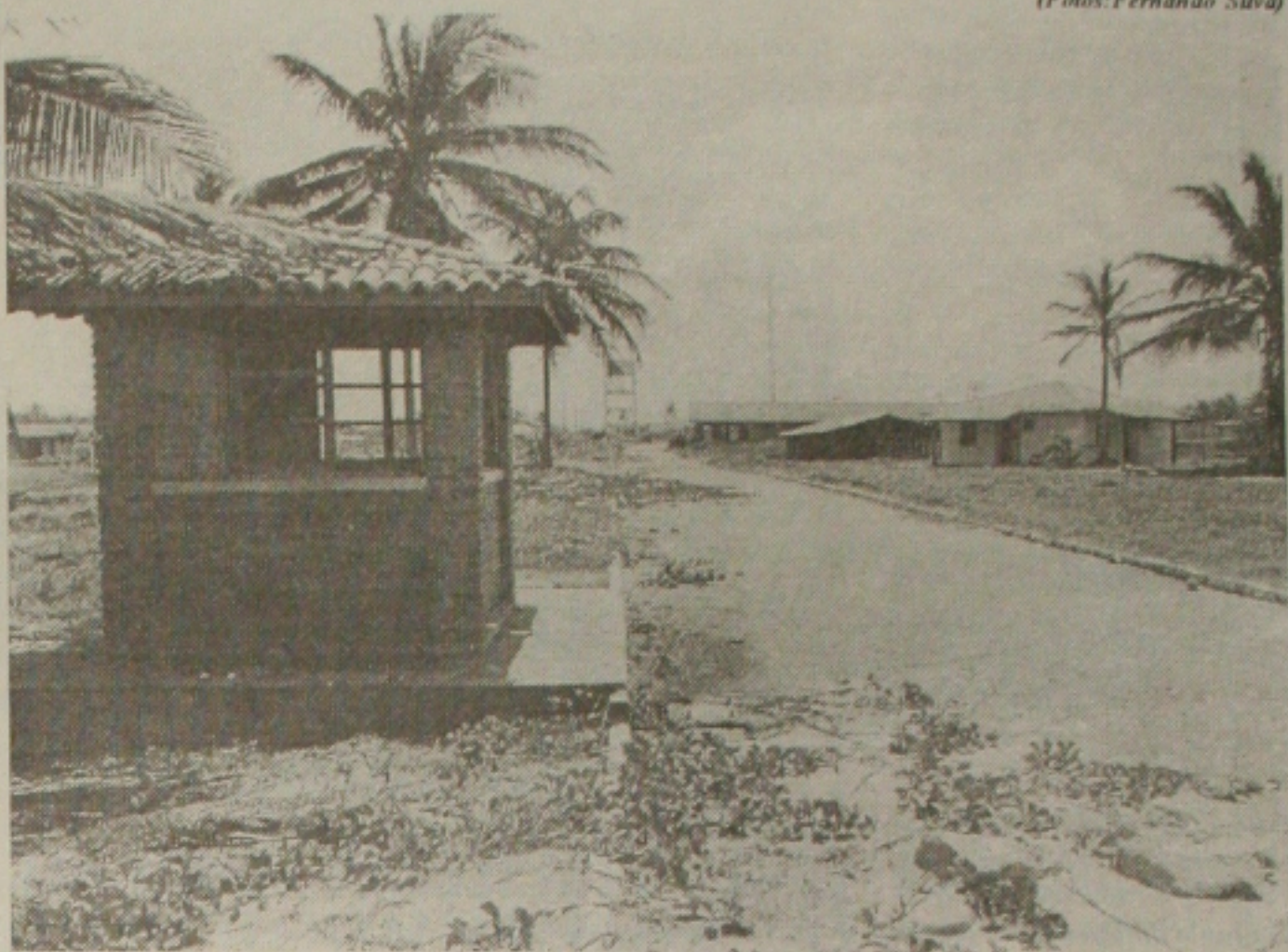
Cenário de beleza contrasta com o abandono e destruição do imóvel
