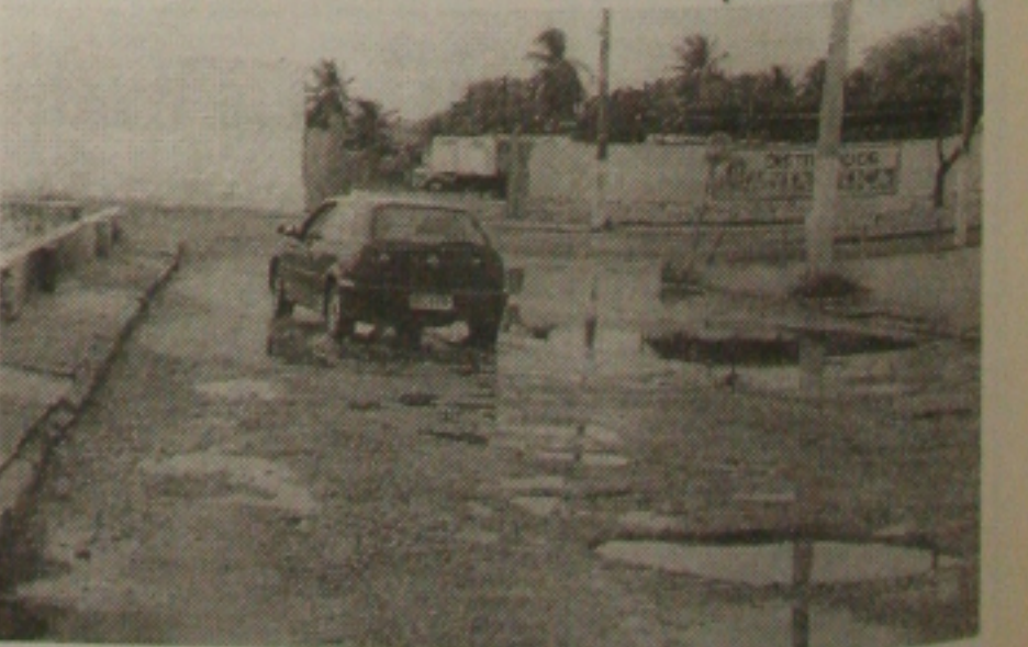
Crateras se formaram no asfalto por falta de providências (Foto)
