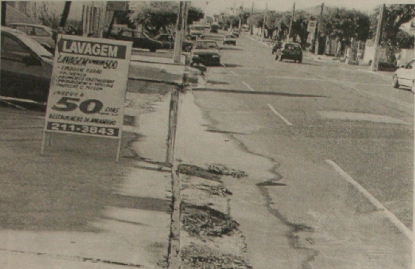
Um esgoto que escorre a céu aberto vem causando transtornos a comerciantes e moradores da avenida Pedro Calazans, esquina com a rua Maruim. (Página 6A)
