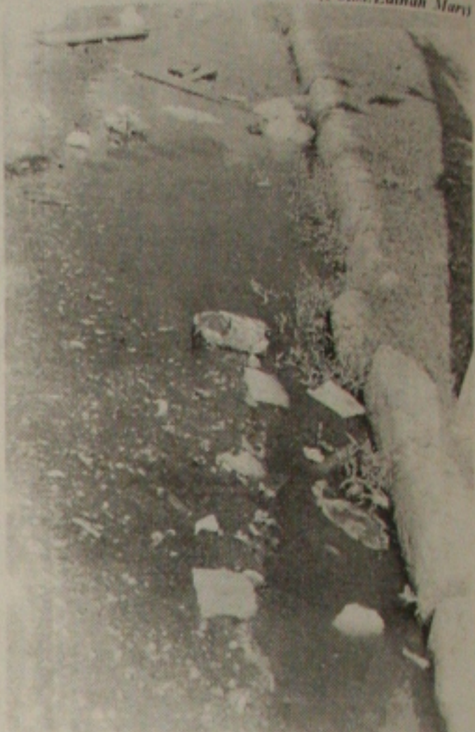
Água com odor escorre pelo meio-fio da calçada
