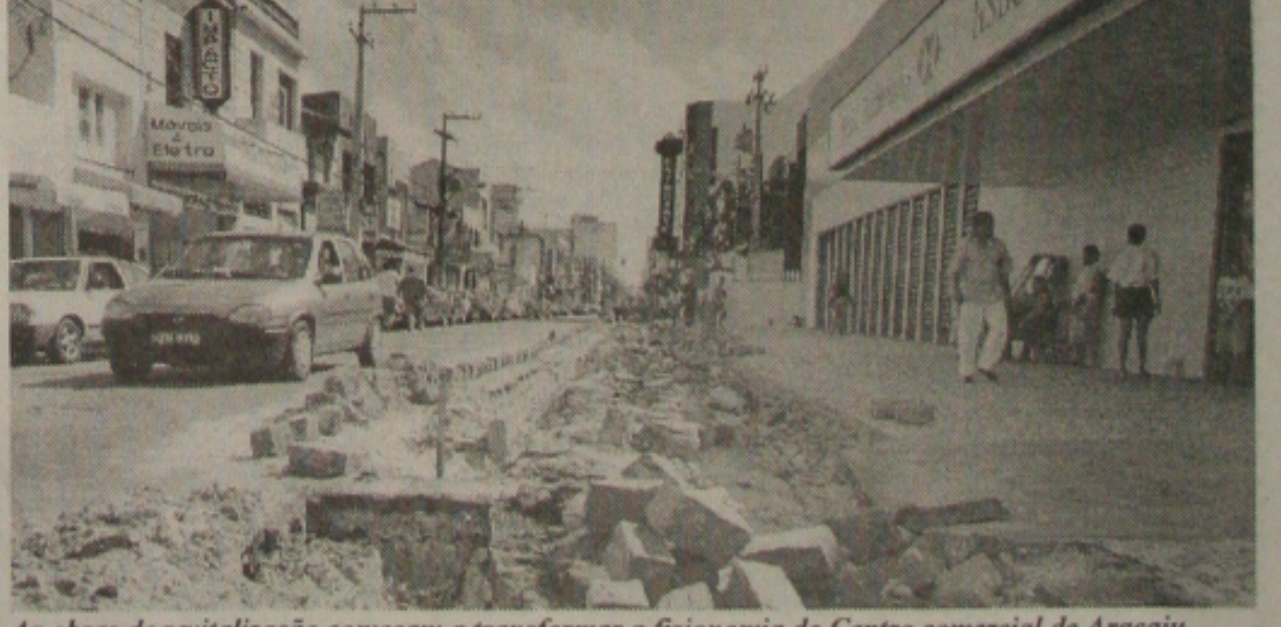
As obras de revitalização começam a transformar a fisionomia do Centro comercial de Aracaju
