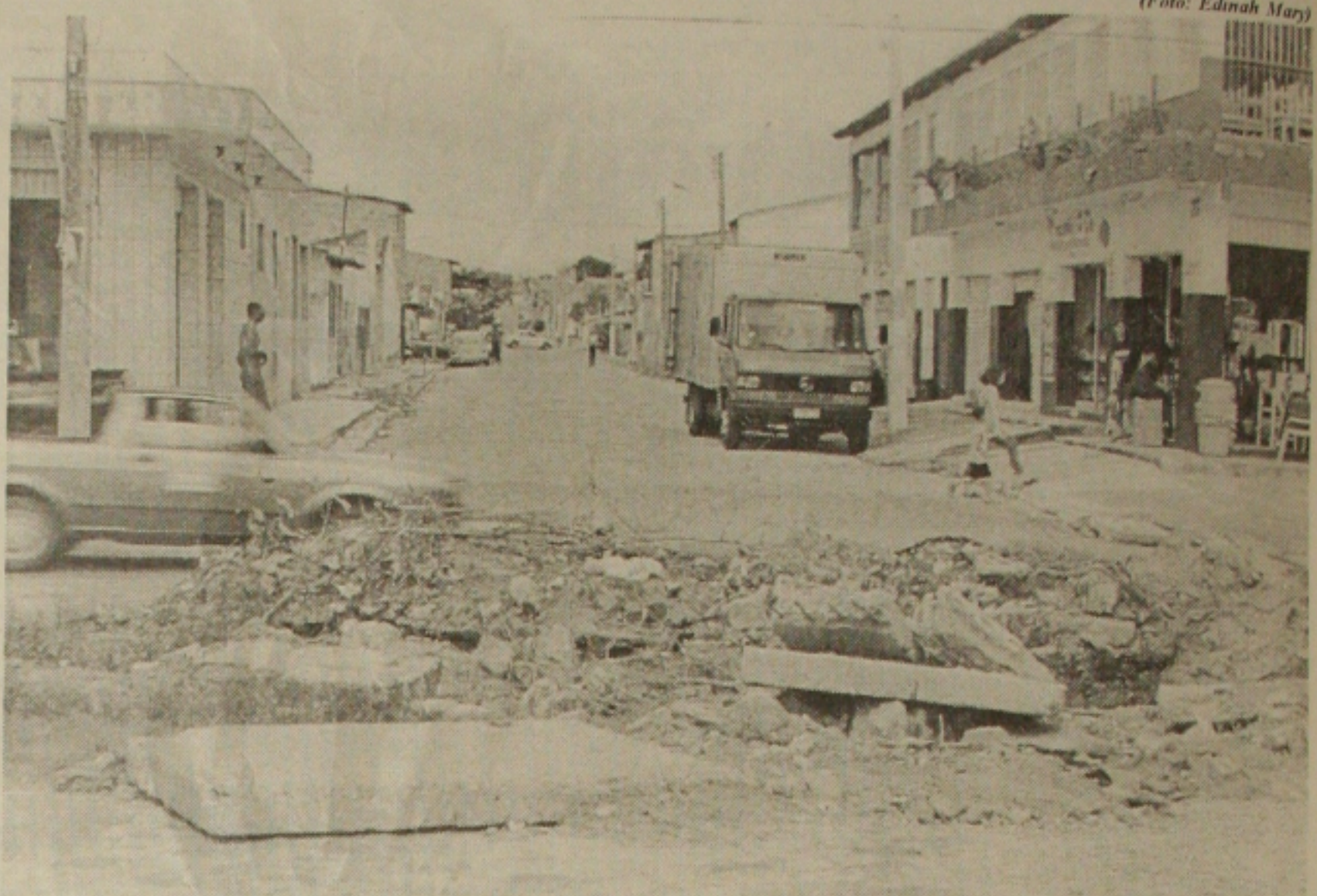
Obra inacabada do Deso resultou na cratera que divide duas ruas no Novo Paraíso
