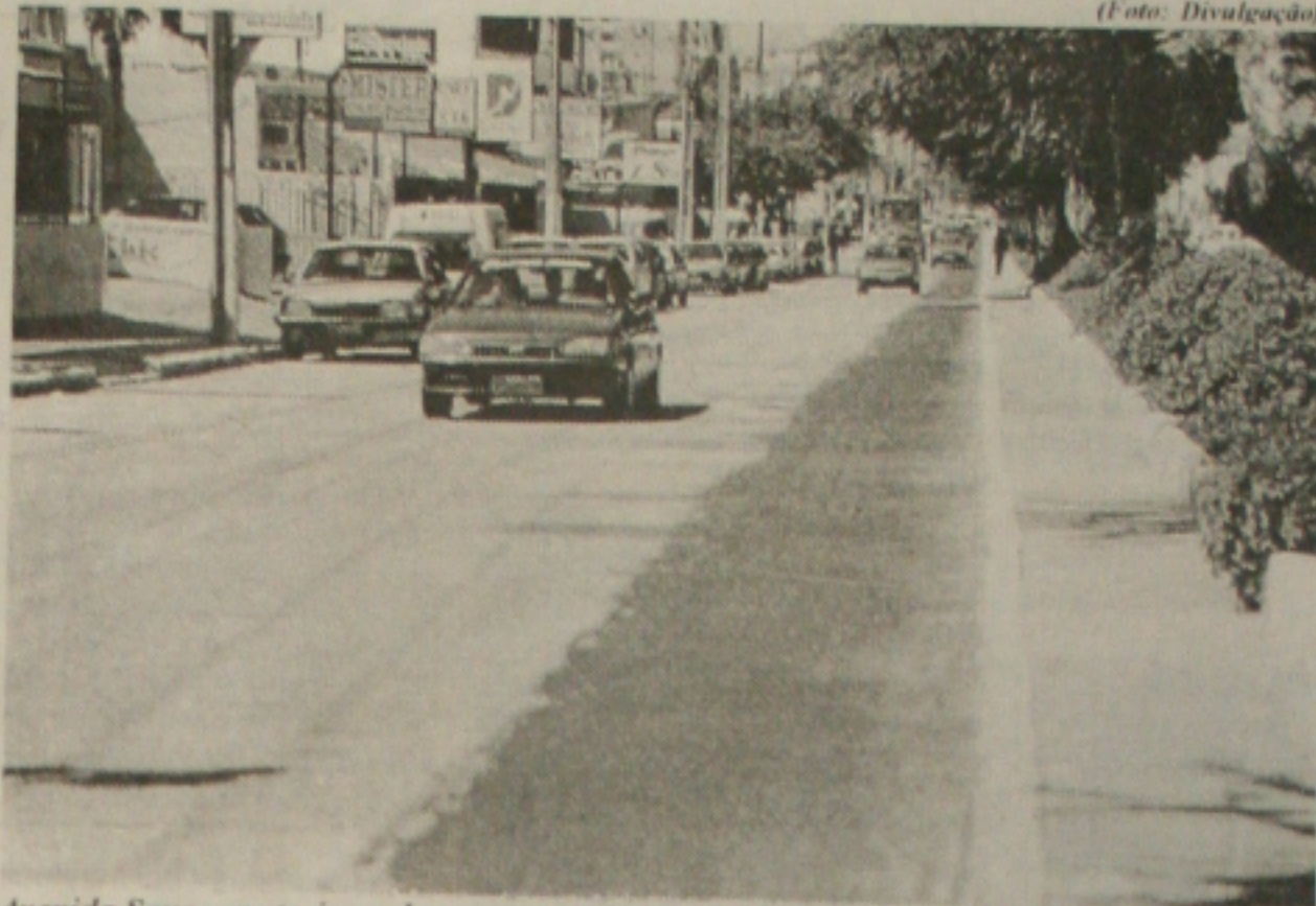
Avenida Saneamento é um dos pontos onde o recapeamento não está satisfazendo
