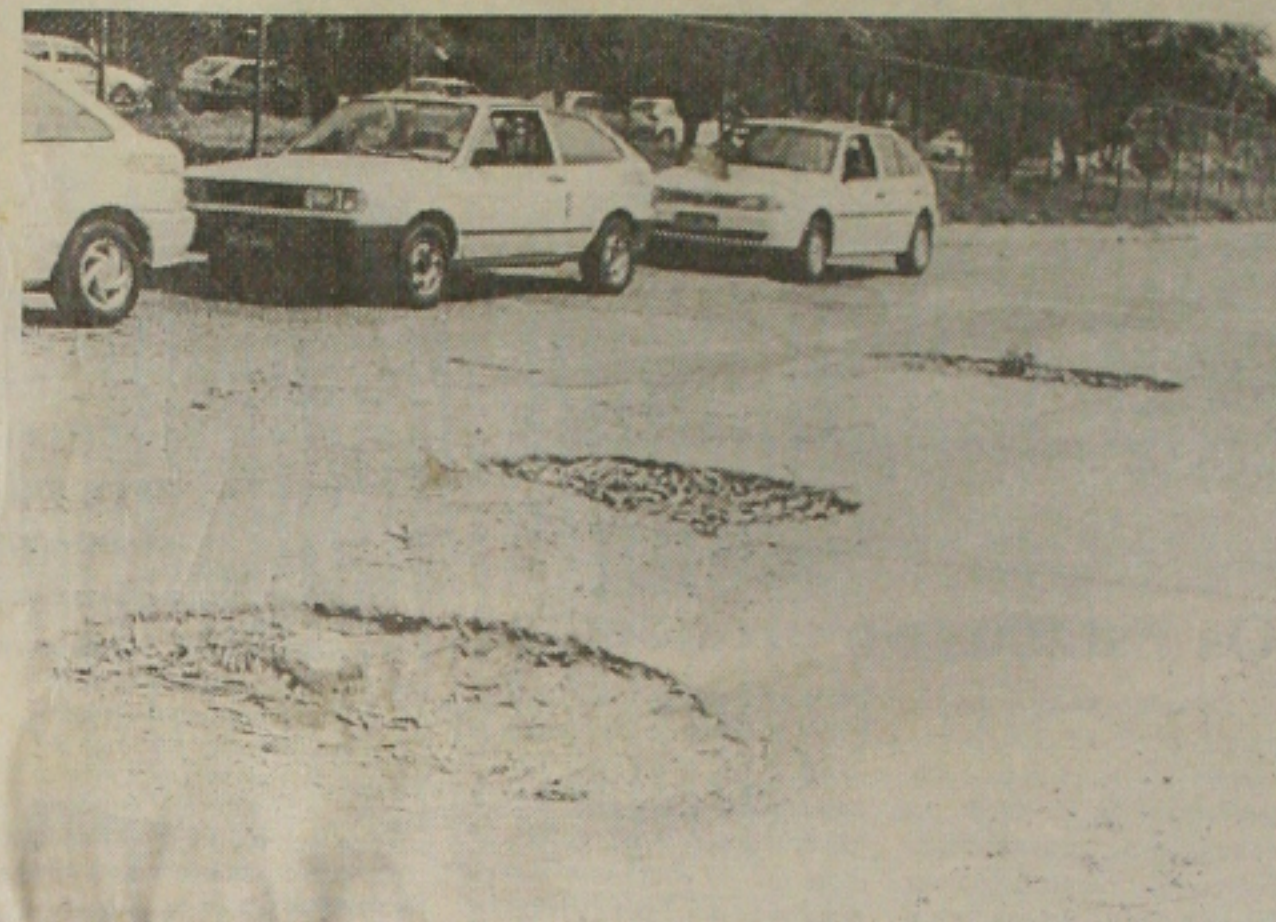
Com vários buracos, as vias de acesso ao Terminal Rodoviário de Aracaju estão em situação caótica. (Página 2B)
