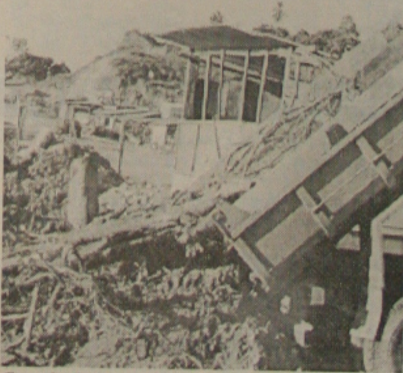
Caçamba despeja entulhos para aterrar manguezal
