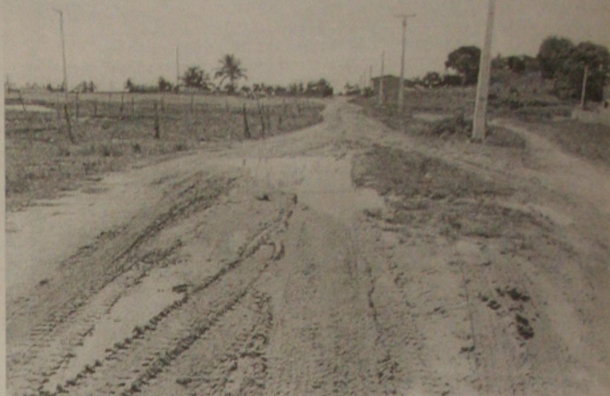
Ruas enlameadas mostram o descaso da administração municipal
