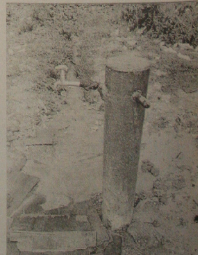
Chafariz é o único que abastece os loteamentos
