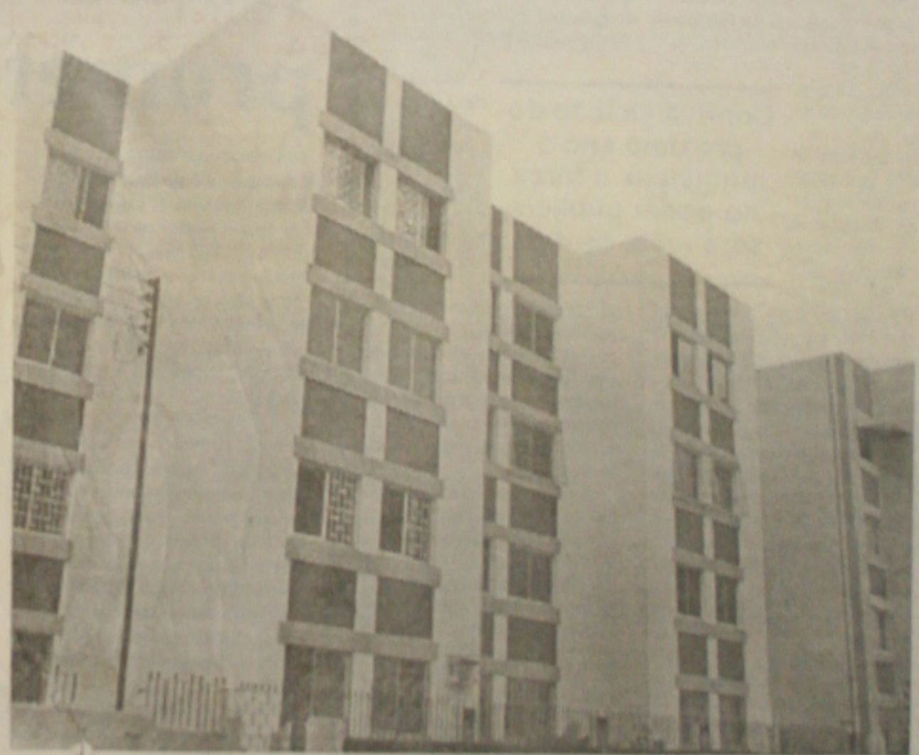
Mudanças na estrutura dos apartamentos podem comprometer toda a estrutura física dos prédios.
