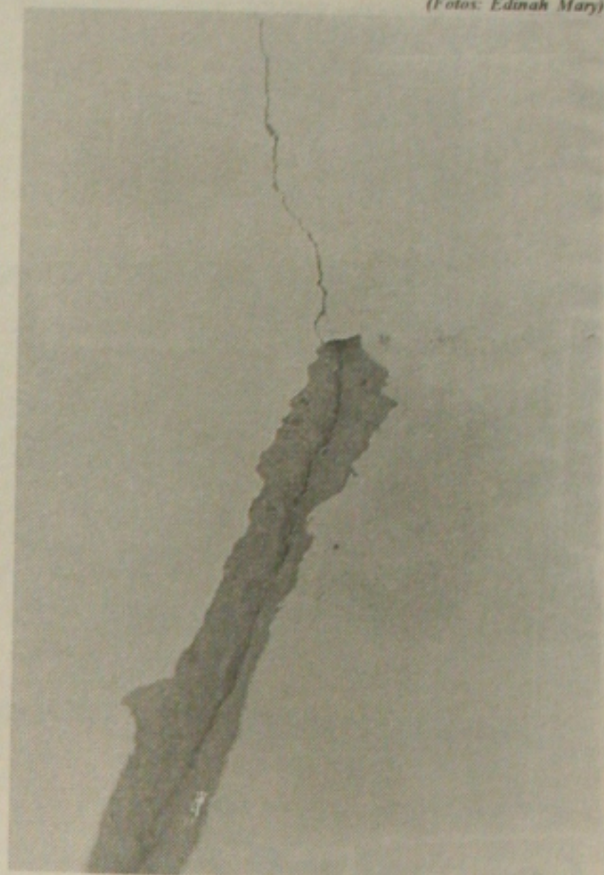
Rachaduras causadas por alteração na estrutura do apartamento
