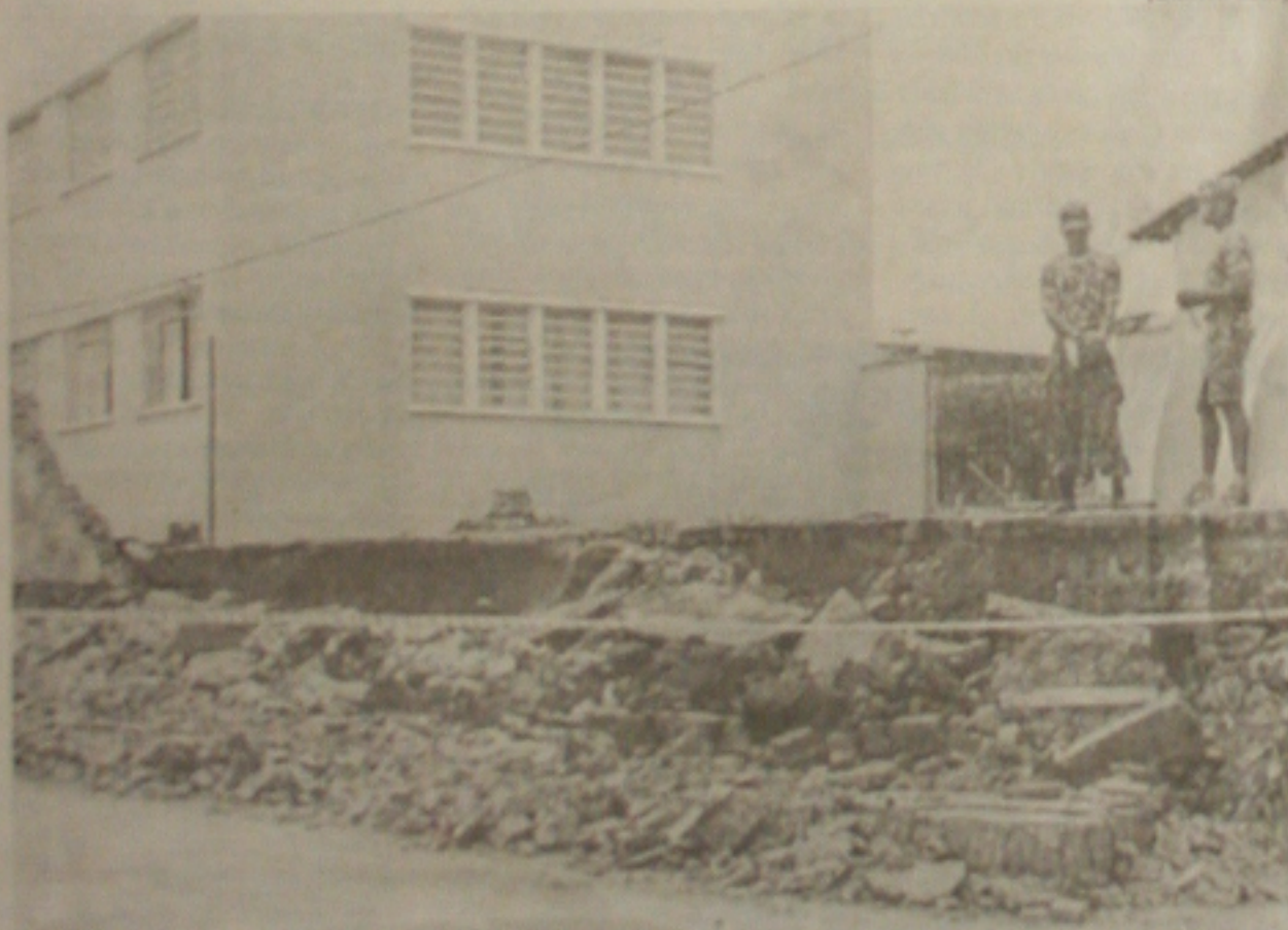
Uma infiltração pode ter comprometido ainda mais o muro do 28º BC, que na terça não resistiu às chuvas e caiu
