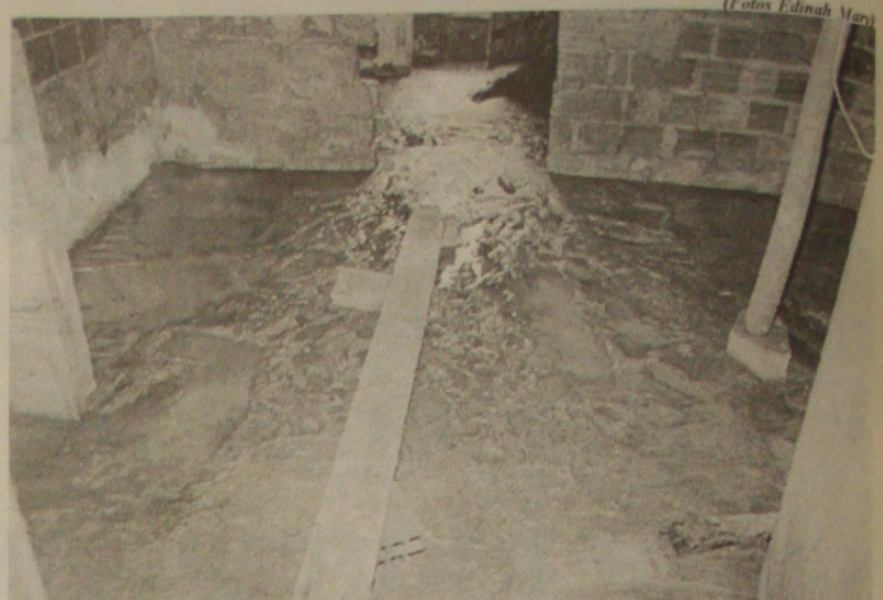
Mesmo depois que as chuvas começaram a cessar muitas casas continuam alagadas
