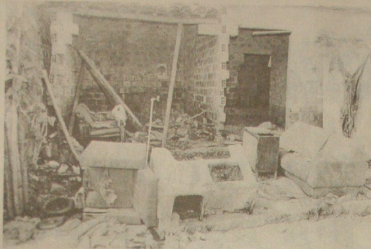
Casa desaba no São Carlos depois da chuva torrencial de quarta-feira
