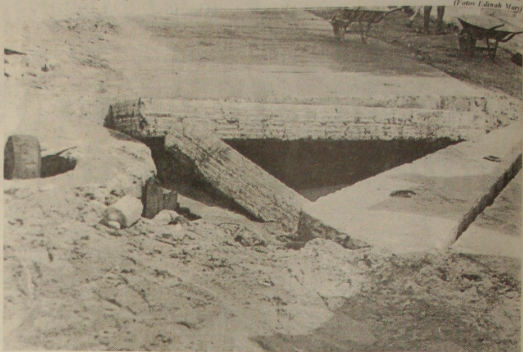
Canal aberto no Lourival Batista é uma obra parada da PMA que quando chove traz tormentos para os moradores
