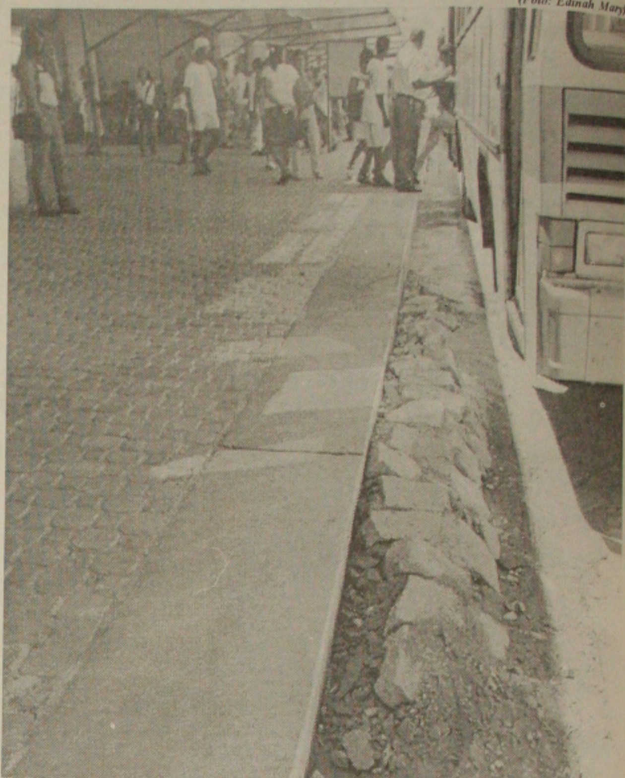
O calçamento a paralelepípedos já começa a apresentar defeitos com o tráfego dos ônibus
