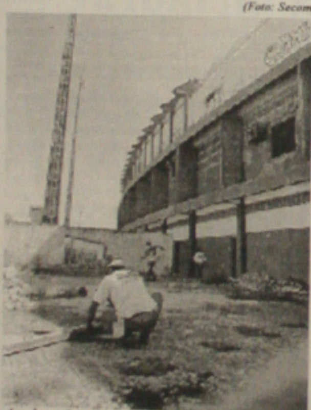
As obras de reforma do Batistão já foram iniciadas e devem ser concluídas até o mês de agosto
