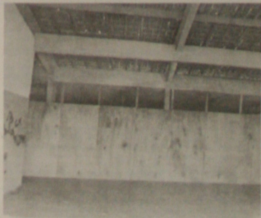
O Colégio João Alves ainda representa perigo para os alunos com problemas em sua estrutura
