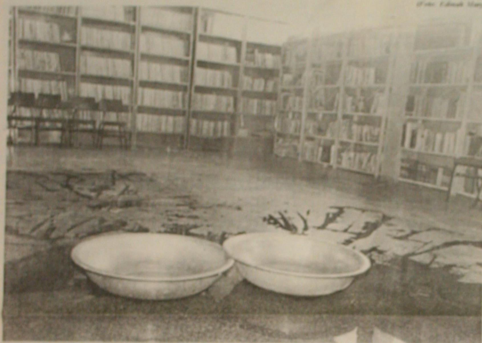
A infiltração na laje tem sido um transtorno e torna-se uma ameaça ao acervo do estabelecimento de ensino
