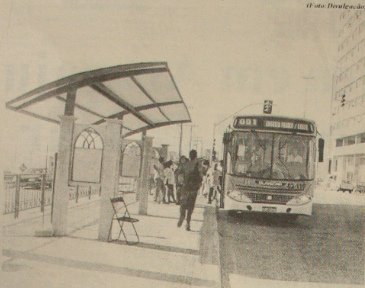
Prefeitura conclui as obras de instalação de pontos de ônibus da Avenida Rio Branco
