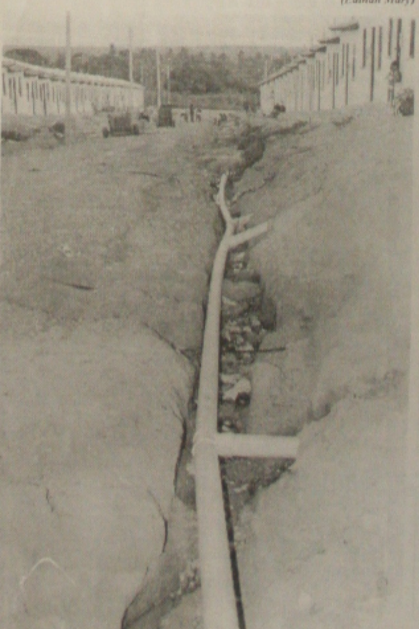
A tubulação implantada pela Deso está exposta e até agora a água ainda não chegou às casas do conjunto
