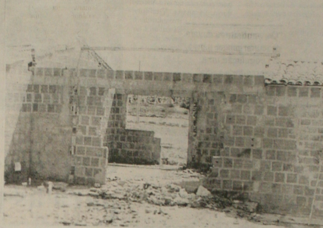
Algumas casas do Conjunto Padre Pedro continuam inacabadas e começam a ser destruídas pelo tempo...
