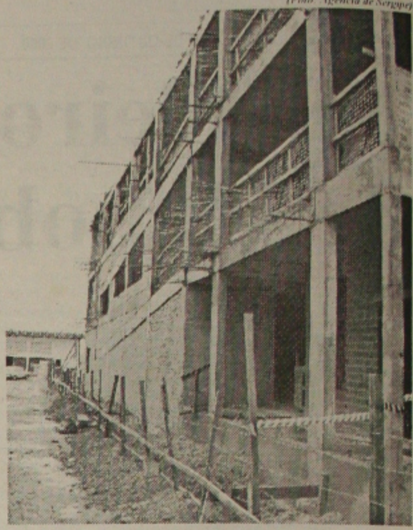
As obras da ala de tratamento de câncer ficam prontas em abril
