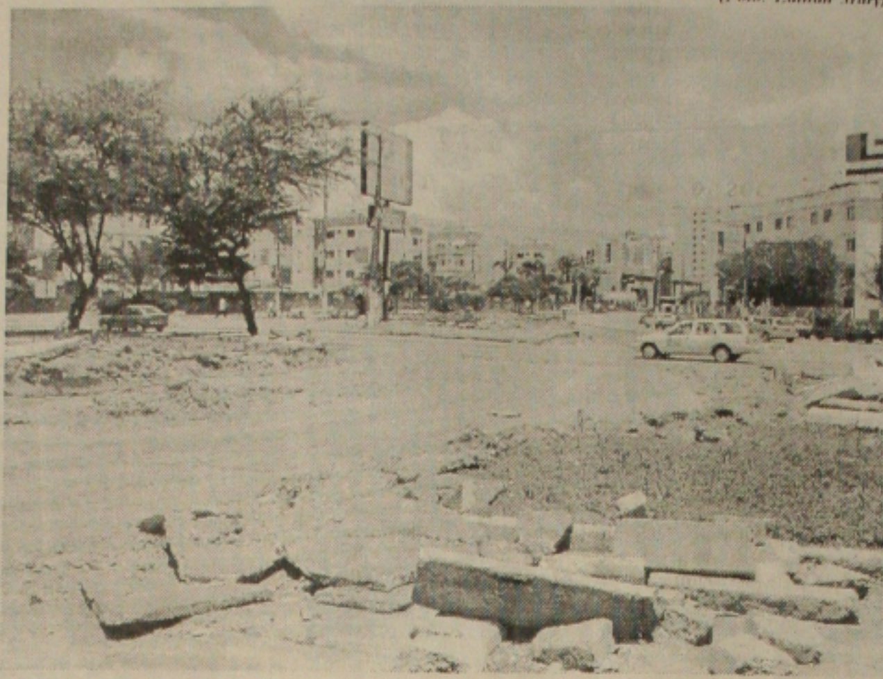
Obras da SMTT vão melhorar o trânsito na Av. Hermes Fontes no cruzamento com a Silvio Teixeira
