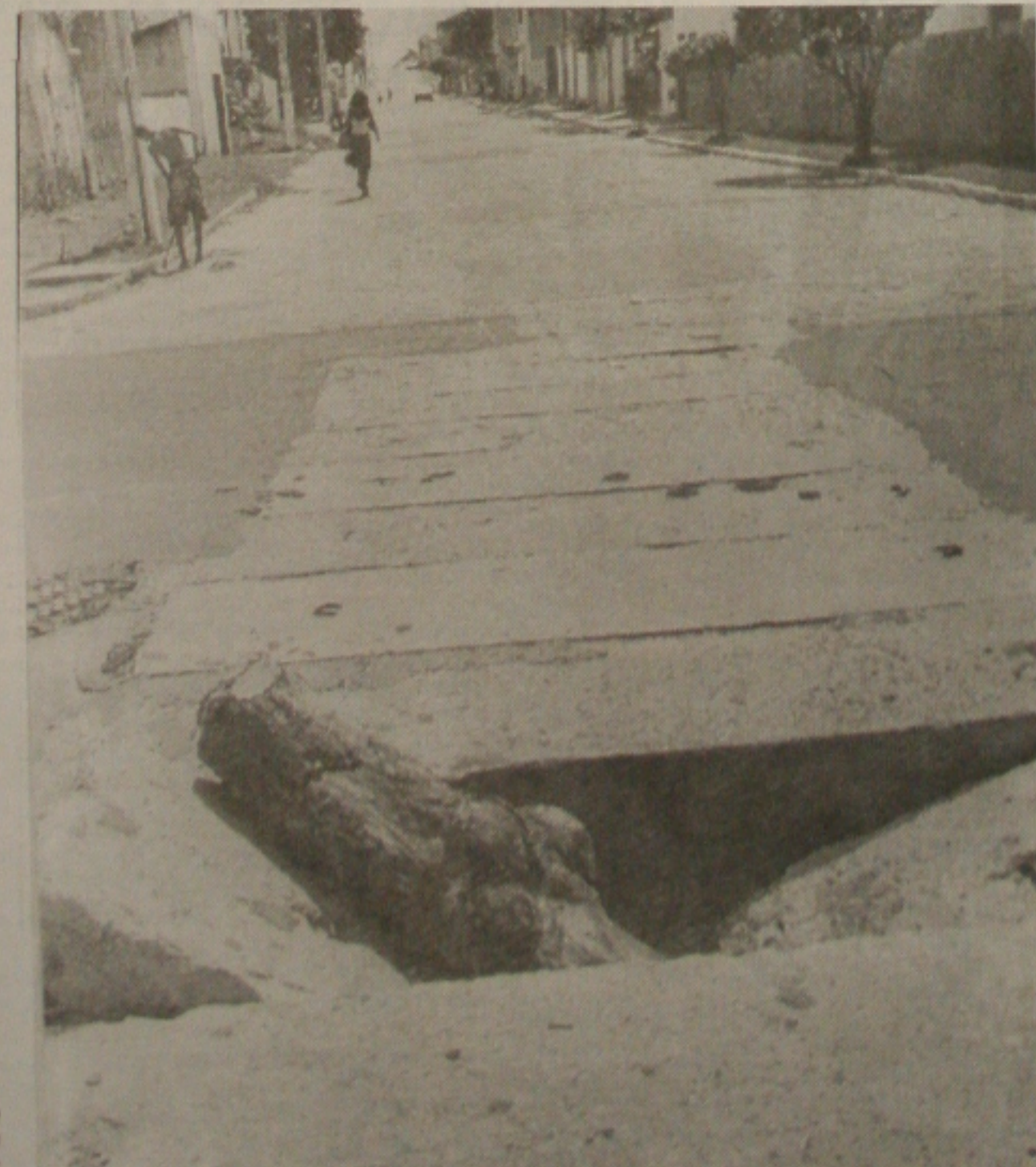
O trânsito fica perigoso com o surgimento de buracos em plena via de escoamento em Aracaju
