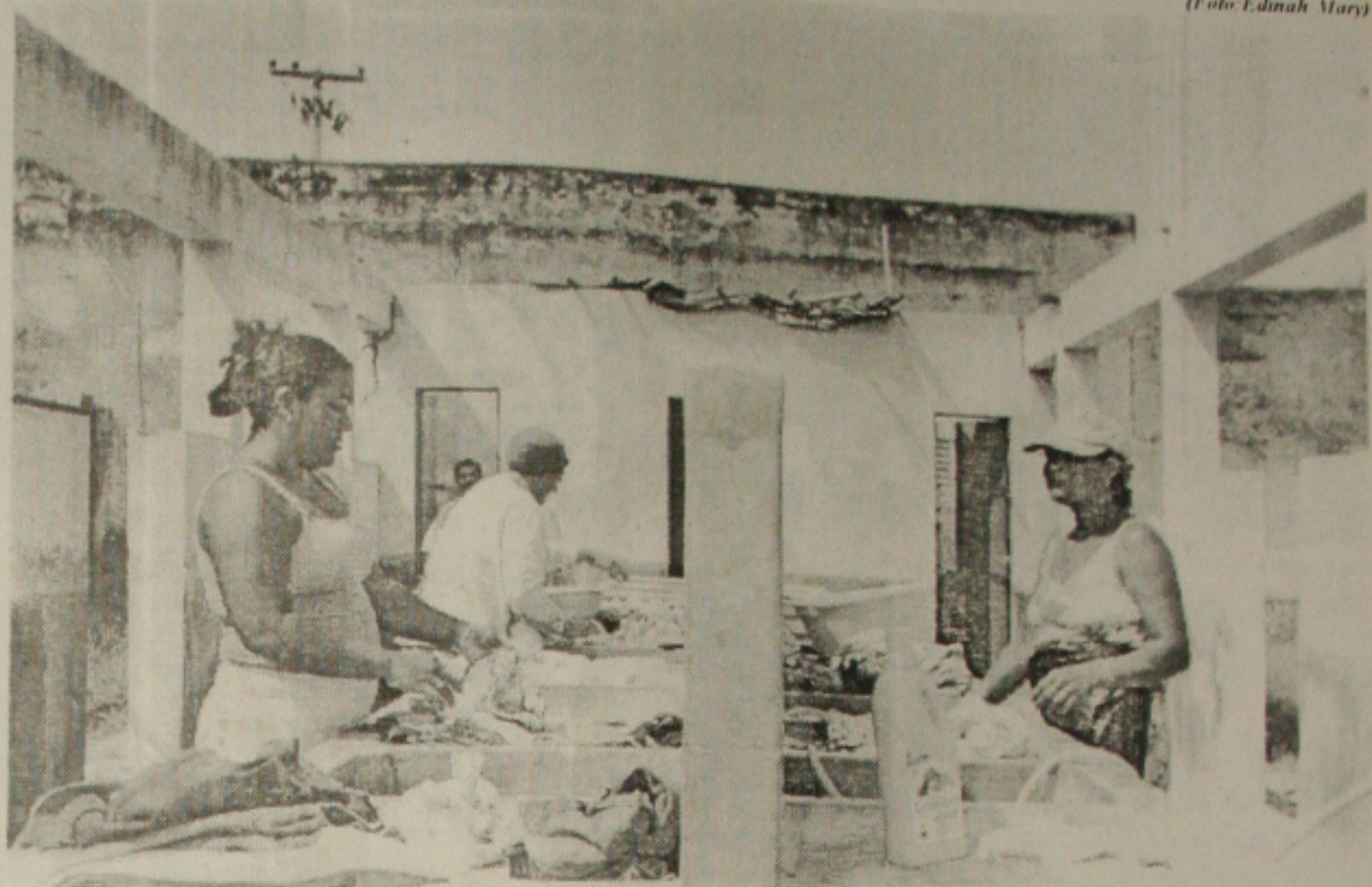
As mulheres enfrentam sol e chuva depois que o telhado da lavanderia desabou em novembro do ano passado
