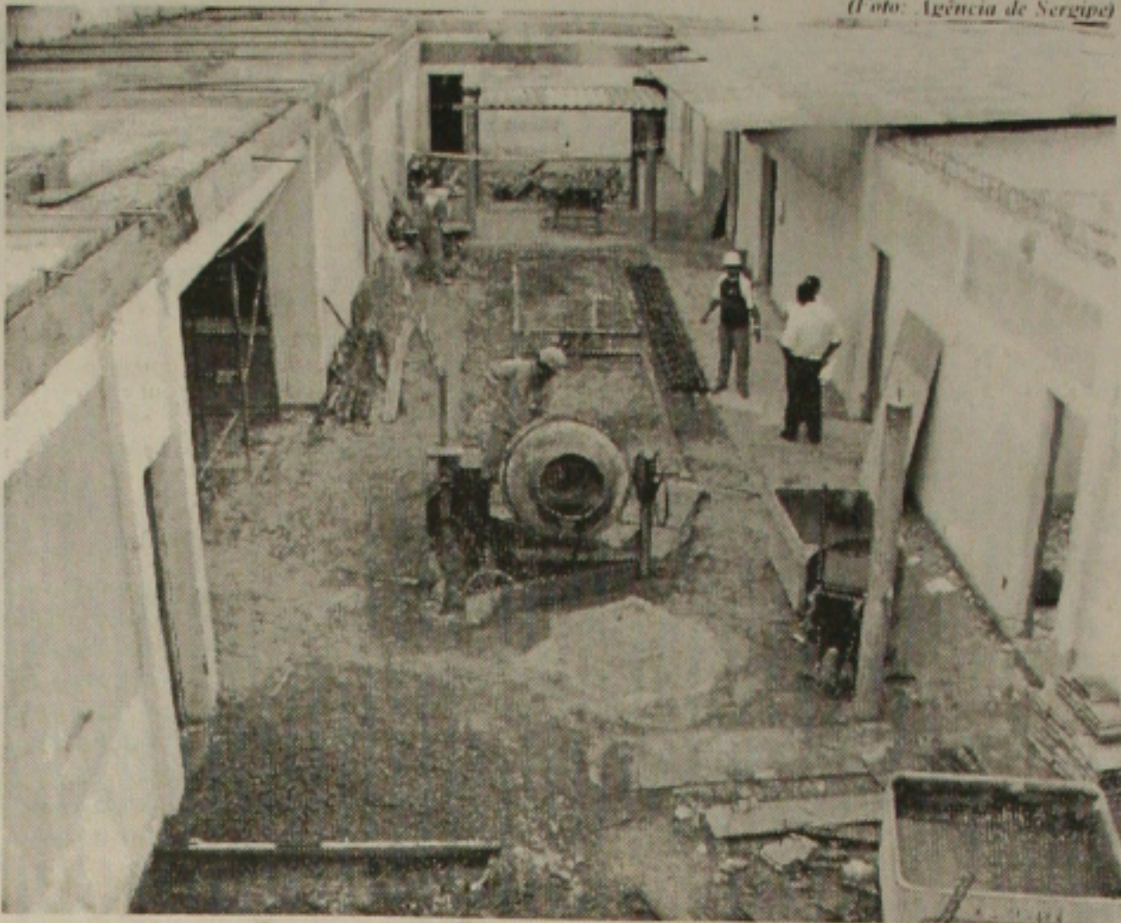
O prédio da Diretoria de Educação de Aracaju passa por ampla reforma de suas instalações
