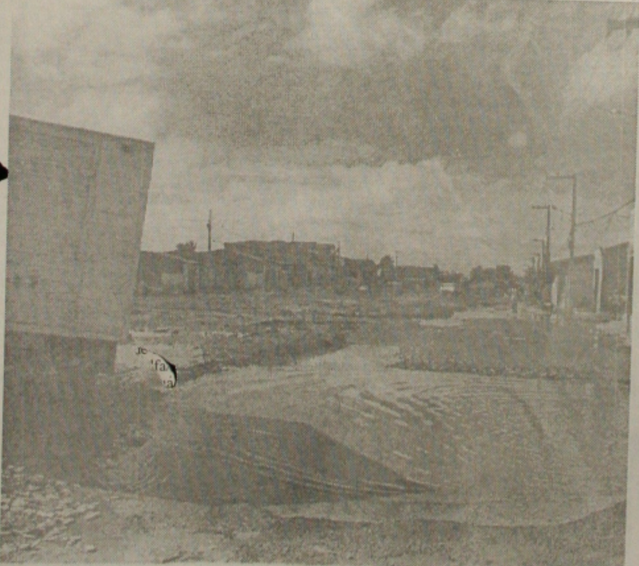
Com as chuvas transitar pela avenida torna-se difícil por causa dos buracos na pista de rolamento
