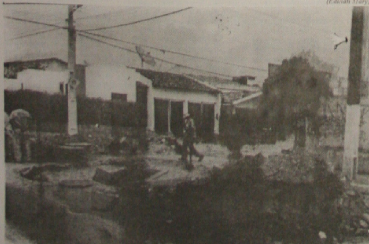
Uma obra inacabada, na Av. Gentil Tavares, vem tirando o sossego de motoristas e pedestres. (Página 4B)
