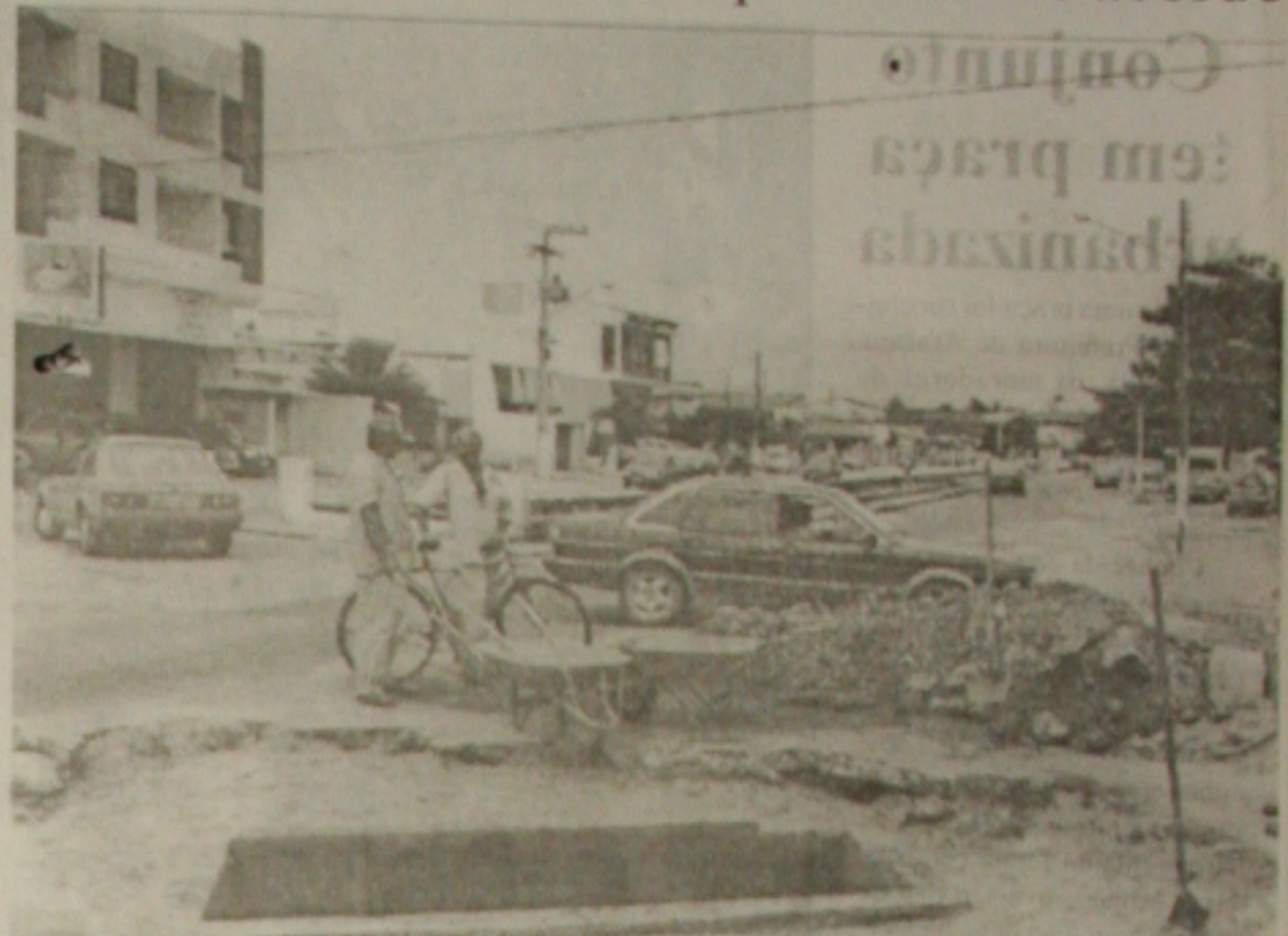
Buraco na Avenida Gentil Tavares gera reclamação de motoristas por causa do transtorno
