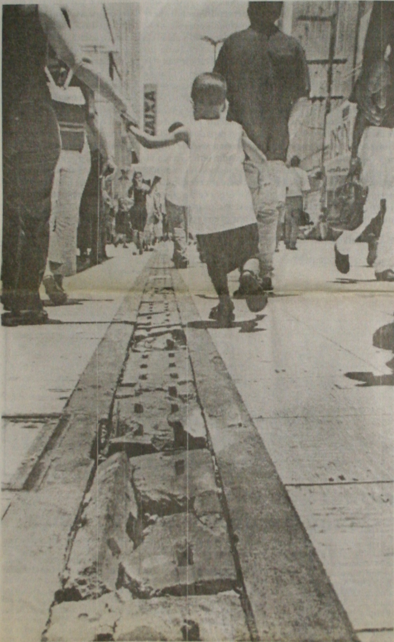
Implantada há pouco mais de um ano, nova calçada do Centro já está se deteriorando em vários trechos
